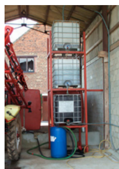
Biofiltre avec unités filtrantes et récupération d'eaux résiduelles
