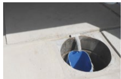
Système de récupération de produit au sol (rigoles + bac collecteur)
